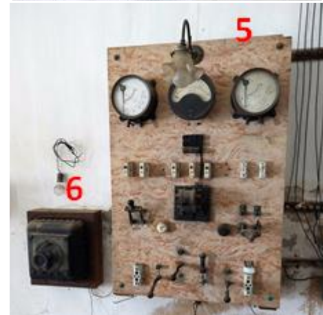
1- Quadro do motor trifásico; 2- Quadro da instalação trifásica; 3- Disjuntor da instalação; 4- Réostato de arranque do motor; 5- Quadro geral de corrente contínua; 6- Réostato do dínamo.
